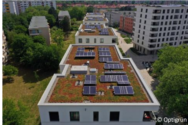
PV-Gründächer zur Energieerzeugung
