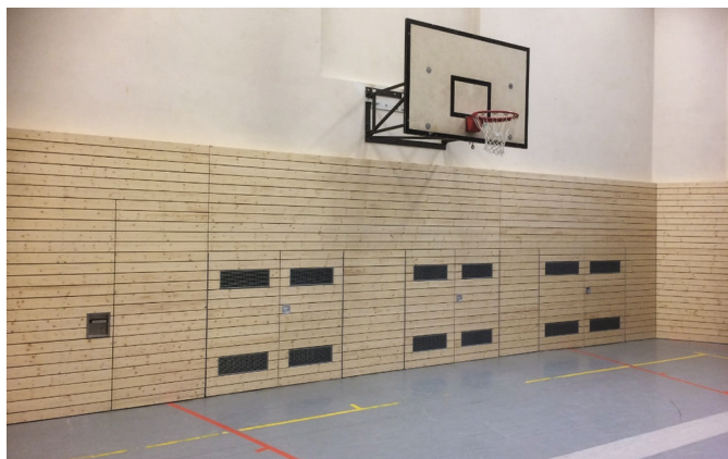
Bild 1. Prallwand mit Geräteraumtoren in einer Sporthalle (Quelle: HARO Sports Flooring).
