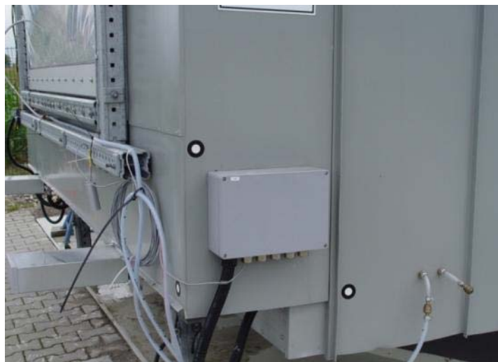
Bild 26: Druckluftversorgung für die Membrankissen. Aktuell ist ein zweilagiges Kissen installiert, das nur eine der beiden verfügbaren Druckluftversorgungen benötigt.
