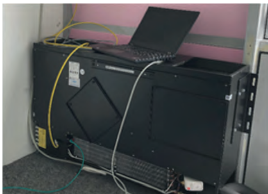
Abb. 74 Innenansicht des DFL-Gerätes während der Inbetriebnahme (IBP)
