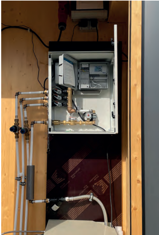
Abb. A18 Rednitzhembach, Technikum/ Fassadenversuchsstand – Bewässerungsanlage (THN-AR)
