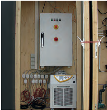
Abb. A5 Schaltschrank, Messumformer Kryostat (THN-AR)
