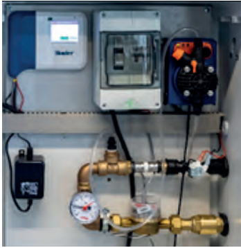
Abb. 83 Schaltschrank zur Bewässerungssteuerung (IBP)
