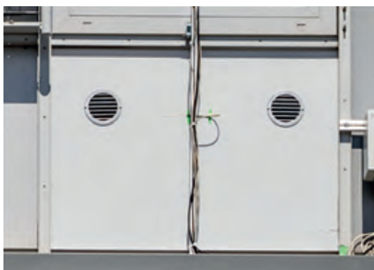
Abb. 76 Frischluft- und Fortluftöffnung mit Insektenschutzgitter (IBP)
