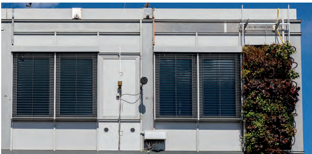
Abb. 89 Außenansicht des Messaufbaus an der Fassade. (IBP)
