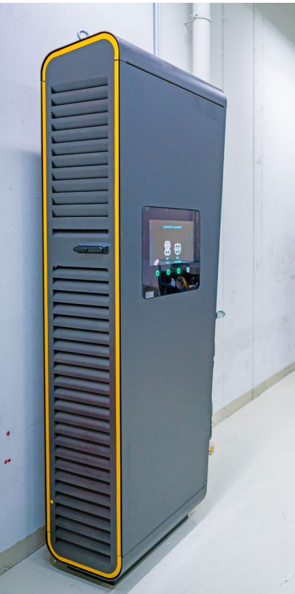
Schnellladesäule für Elektrofahrzeuge im Vorbereitungsraum des Fahrzeugakustiklabors. © Fraunhofer IBP / Benjamin Müller
