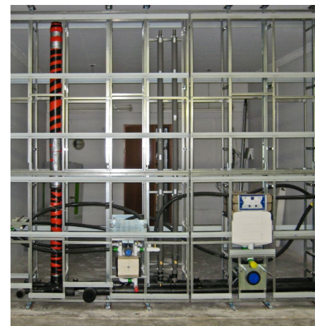
Systematisch planbare Sanitär-Installation aus vorgefertigten Installationsregistern.
