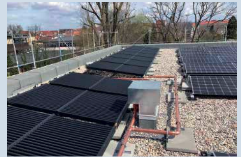
Figure 13: The solar thermal collectors Photograph: Ingenieurbüro Willhaug Gebäude- technik GmbH
