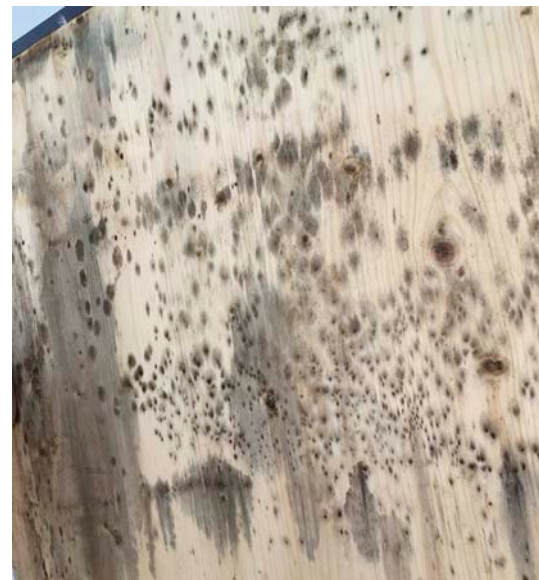
Bild 9. Nach einer Winterperiode geöffnete Schalung eines Flachdachs, welche vermutlich durch konvektiven Feuchteeintrag verursachte erhöhte Feuchtegehalte aufweist Fig. 9. After a winter period opened flat roof timber sheathing with high water contents potentially caused by convection moisture entry
