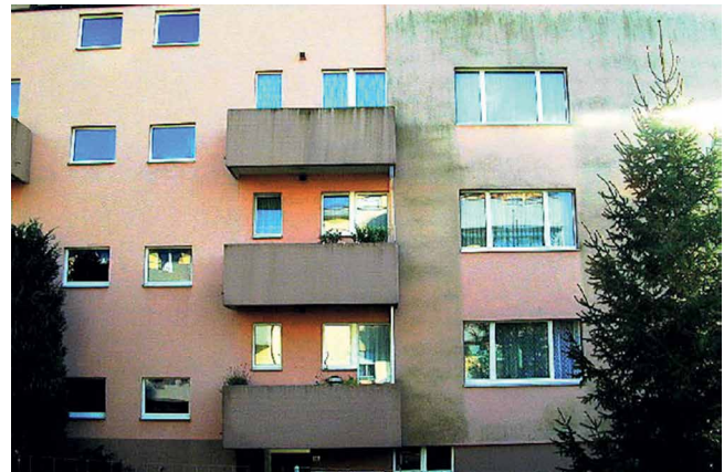
Abb. 2: Ansicht eines Gebäudes, auf dem die rechte Seite ungefähr ein Jahr zuvor gedämmt wurde. Der höhere Dämmstandard fördert augenscheinlich das Wachstum von Algen oder Schwärzepilzen (aus [2]).
