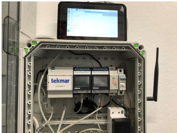
Bild 106: In die Versuchseinrichtung (hier im CUBE) installierte tekmar-Komponenten für die Regelung des Windheizung 2.0-Konzepts.
