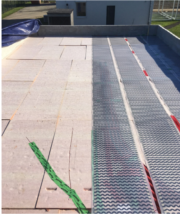
Bild 105 Adiabatsystem der Testraumdecke des CUBEs während des Aufbaus. Auf der rechten Seite des Daches sind vier der Heizfolien bereits ausgelegt.
