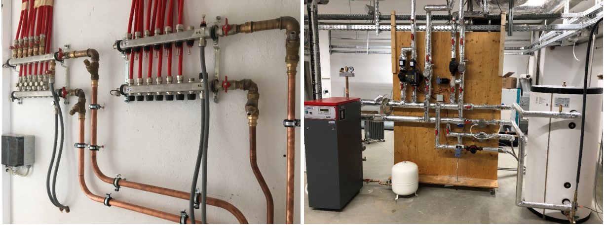
Bild 102: Hydraulische Versorgung des BTA-Speichers. Links die Geschossverteilung für BTA und aktive Entladung im Erdgeschoss-Korridor. Rechts die Versorgung im Keller mit dem 50 kW Durchlauferhitzer auf der linken Seite der Regelungsmimik und rechts die Rücklaufwärmepumpe zur TWW-Bereitung.
