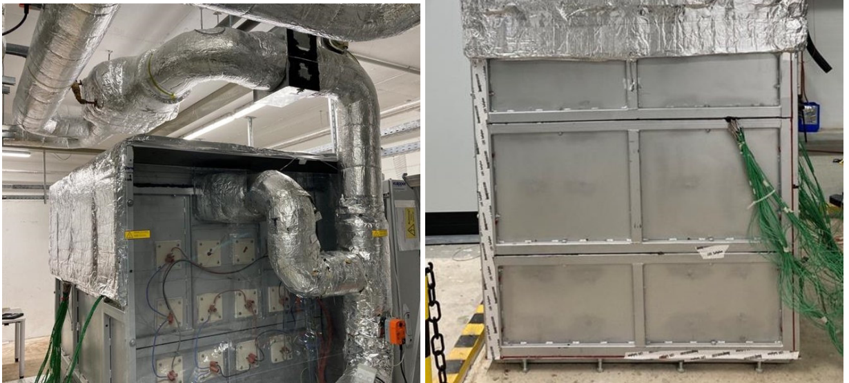
Bild 100: Zusätzliche, nachträgliche Wärmedämmung im oberen Bereich des HTSS. Links: Frontansicht, rechts Rückansicht.
