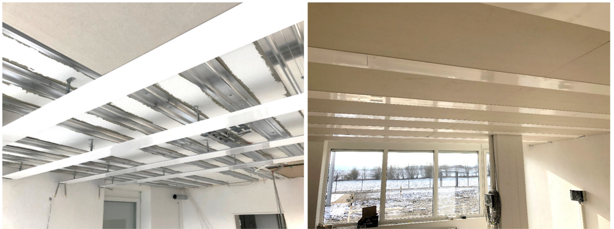
Bild 80: Eingebaute Sanierungsdecke im N2-Zwillingshaus des Fraunhofer IBP: Links im geöffneten Zustand mit den blanken Aluminium-Lamellen des BTA-Speichers und den weißen Profilen der aktiven Entladung. Rechts im geschlossenen Zustand; die Gipskartonplatten verdecken bzw. tragen die Calostat-Dämmplatten.
