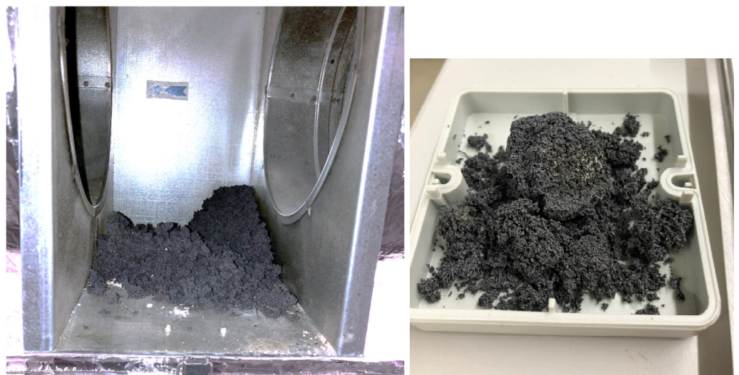
Bild 117: Rückstände im (leeren) Filterkasten des Heißluftkreises.
