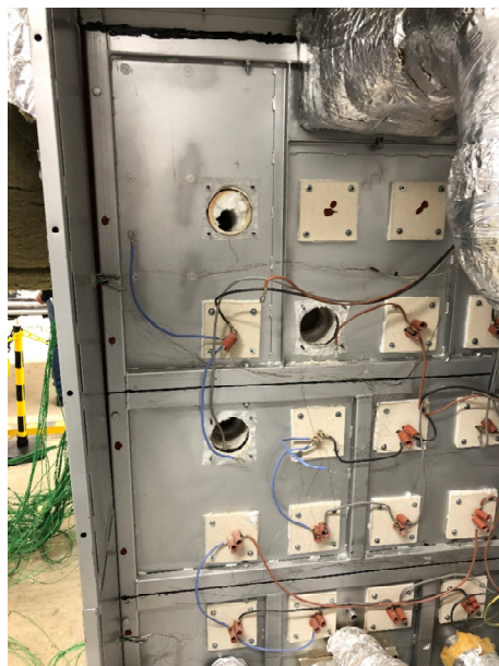
Bild 109: HTSS mit 3 rückgebauten Heizwendeln Nr. 1, 4 und 7.
