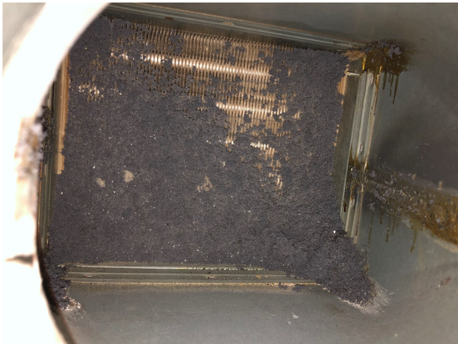
Bild 119: Dichtschaumreste der Brandschutzklappe angesammelt am TWW-Wärmetau- scher.
