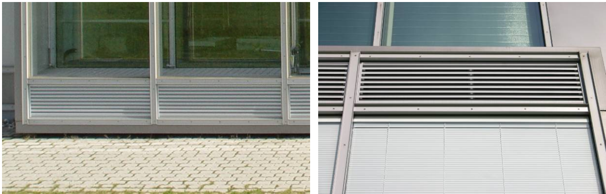
Bild 14: Lüftungsgitter im unteren (linke Bildhälfte) und oberen Bereich der Doppelfassade (rechte Bildhälfte).
