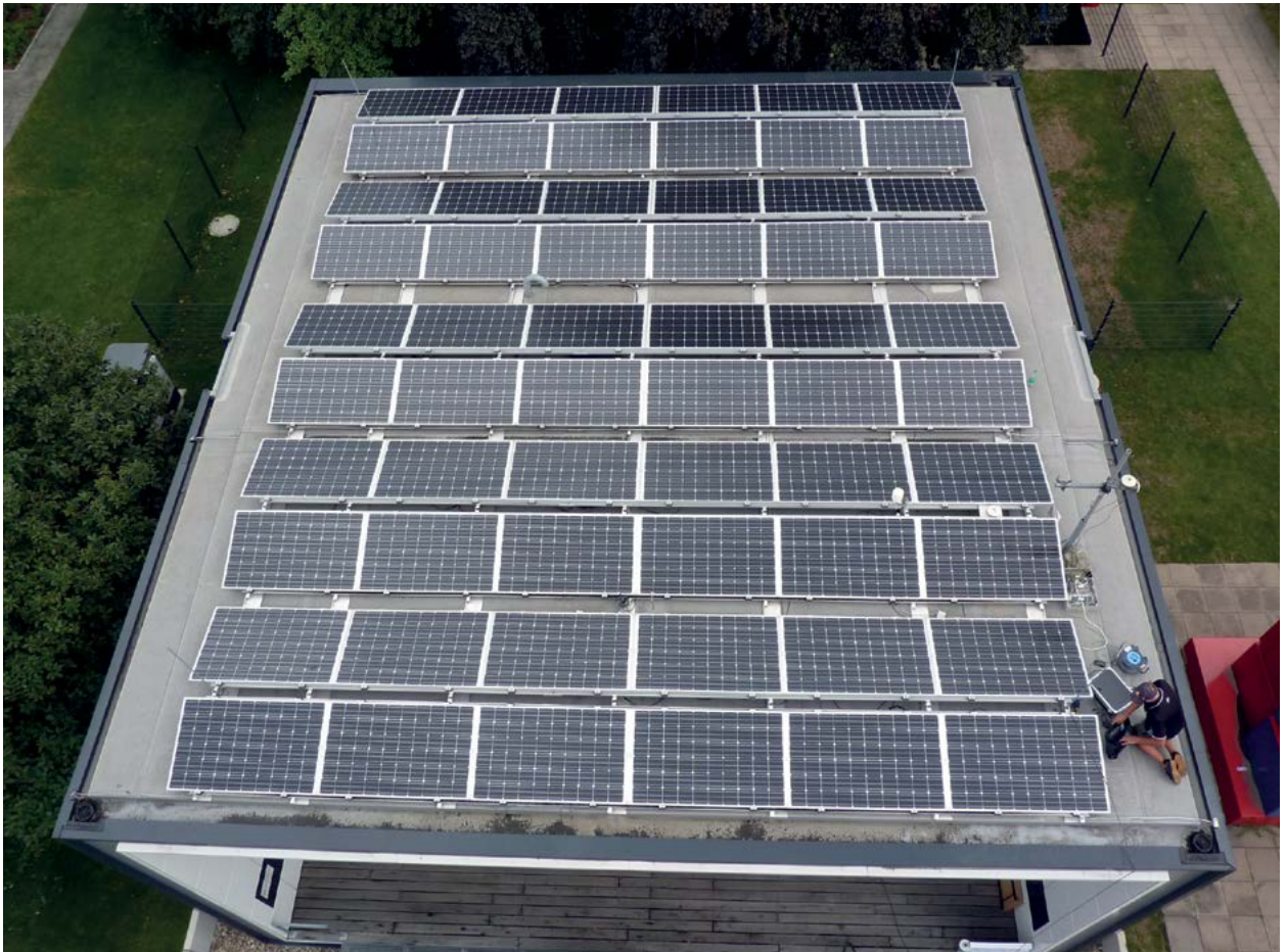
Dachfläche mit monokristallinen Photovoltaikmodulen
