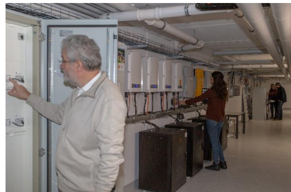
Abbildung 2: Technikzentrale des Reihenhauses
