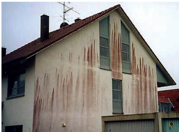
Bild 1: Algenbewuchs auf der Fassade. Deutlich zu erkennen ist der Einfluss des geringen Dachüberstandes [2].
