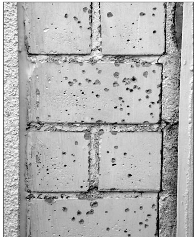
Bild 1: Fotografische Aufnahme von Frostschäden an einer Westwand aus Kalksandstein im Gelände der Freilandversuchsstelle Holzkirchen des IBP nach dem Winter 1998/99.
