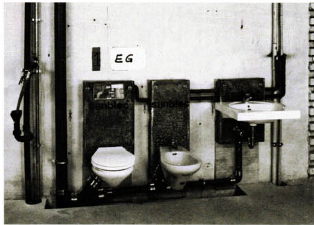
Bild 3: Vorgefertigte Sanitär-Bausteine an der Installationswand im EG des Installations-Prüfstandes
