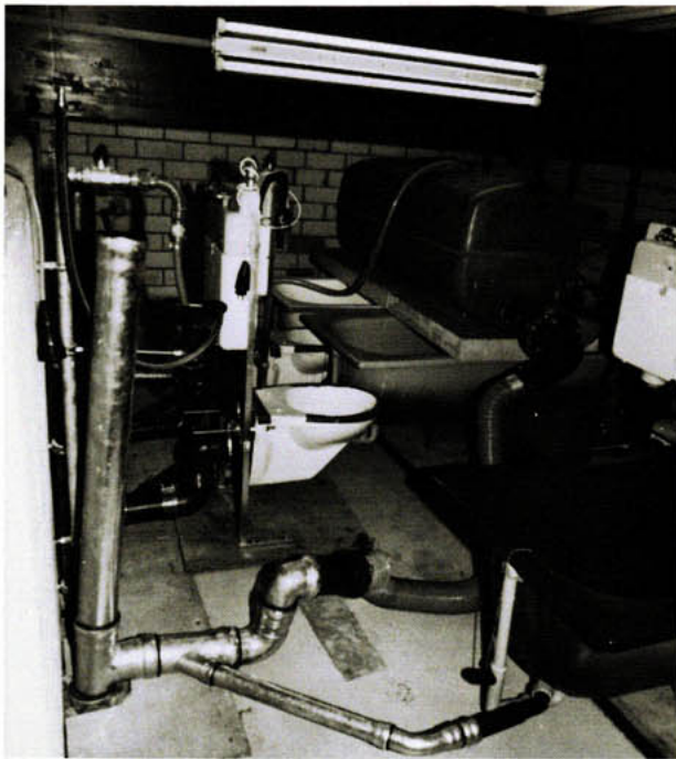
Bild 2: Untersuchungen verschiedener Abwasser-Rohrsysteme: Wannen-, WC- und Dachentwässerungs-Anschlüsse im DG des Installations-Prüfstandes
